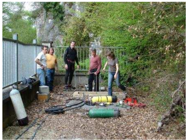
les accès à l'eau. Notez le tuyau du marteau-piqueur alimenté par la 20 l.
